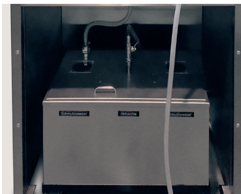
Wasseraufbereitung mit Aktivkohlefilter
